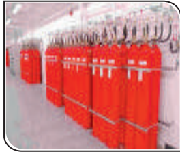
Co2 Gas Bank
